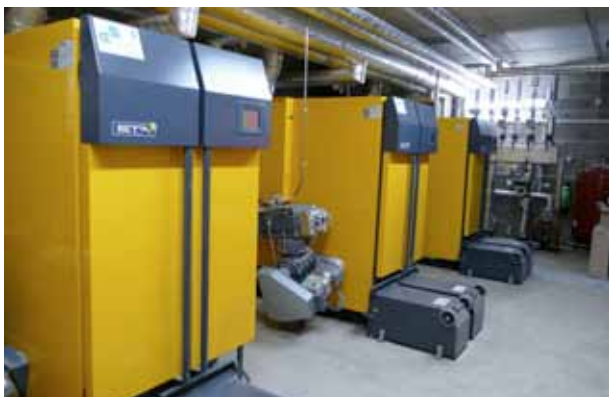
Chauffage urbain Eschweiler / Photo: Inez Verharen
