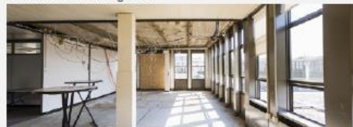
Figure 25 - Bureau test, appelé mock-up, totalement déconstruit pour analyser les matériaux présents Source : https://www.wort.lu/fr/luxembourg/les-matieres-du-batiment-jean-monnet-recycle
