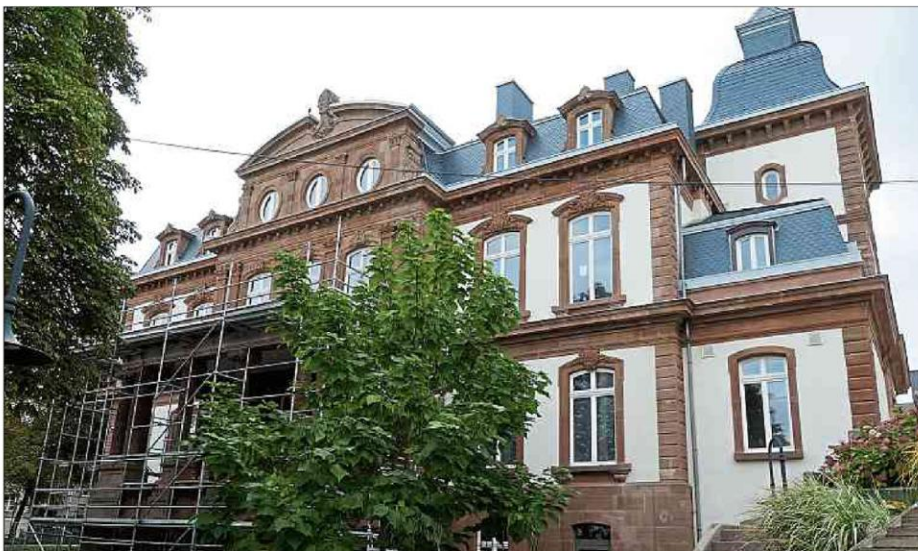
Das 1880 errichtete Patrizierhaus, in dem sich seit 1966 das Wiltzer Rathaus befindet, beheimatete dereinst mit der Familie Thilges eine der wohlhabendsten Industriedynastien der Stadt.
